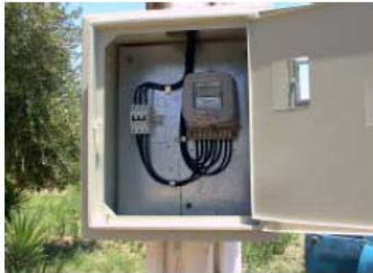
INTERIOR: MEDIDOR / PROTECCIÓN
